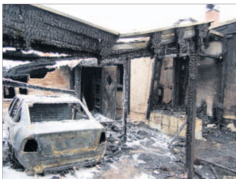
Ein technischer Defekt an einem vor dem Haus geparkten Auto setzte zunächst das Fahrzeug in Flammen. Dann griffen sie aber auch auf das Gebäude über, das zum Großteil mit Holz verkleidet ist. Foto: Mirko Kolodziej
